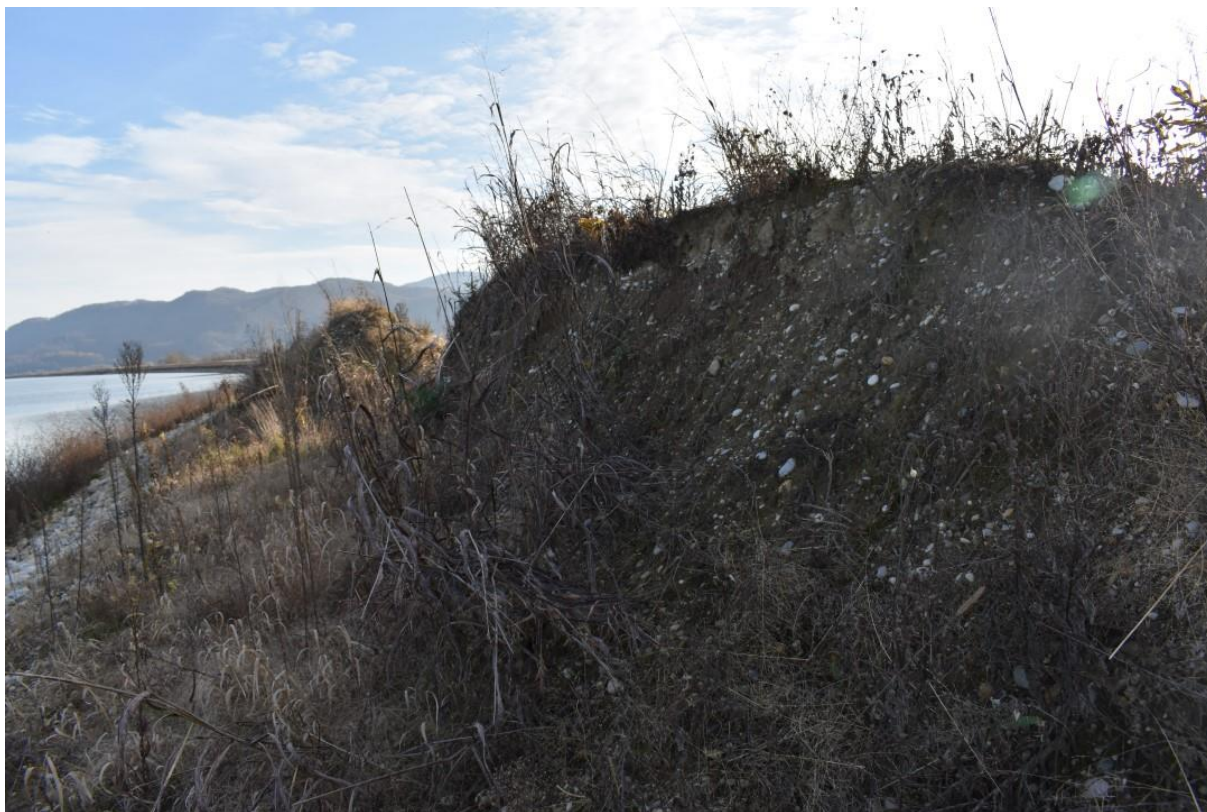
Slika 38: Stene so zgrajene iz neprimernega materiala
