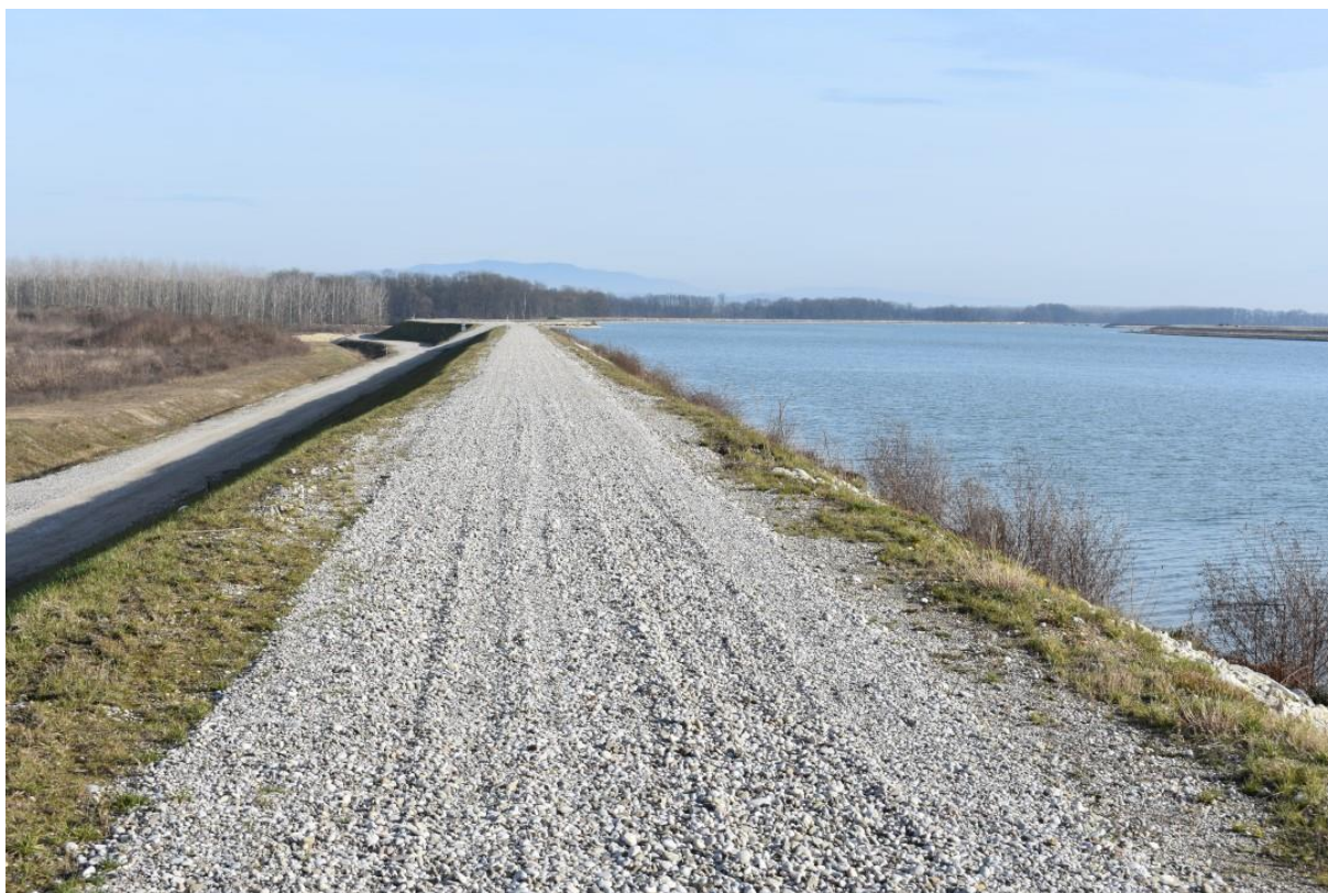
Slika 57: Ozelenitev zgornjih delov utrjenih brežin z avtohtonim rastjem ni izvedena
